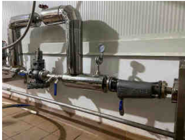
Tubería y válvulas de control de vapor entrada cuarto planta piloto de bebidas carbonatadas
