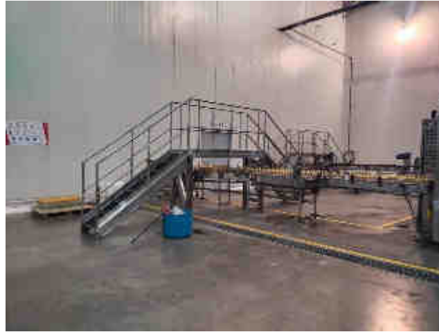
Plataforma de acceso operacional final líneas 1 y 2
